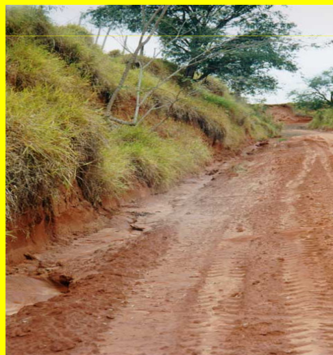
Plataforma degradada e taludes erodidos (Antes)
